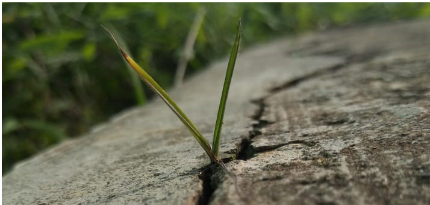
Foto Alexandra Gómez Arboleda. Las grietas son recurrentes en algunas zonas de San Cristóbal.
